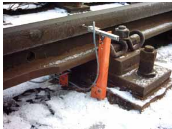
Weggeber an einer Messstelle
