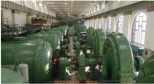
WASSERKRAFTWERK OLIDAN, TROLLHÄTTAN
