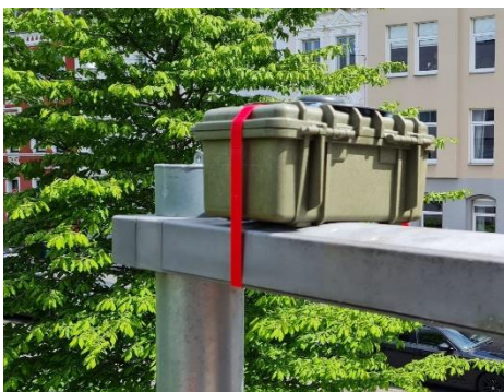
INSTALLIERTE LOW-COST GNSS STATION AUF STRASSENLATERNE
