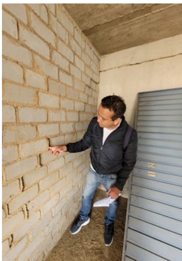
SCHÄDEN AN EINER GARAGENWAND IN DÜREN, NRW
